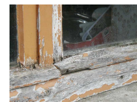
Menuiserie extérieure en mauvais état Peintures écaillées pouvant contenir d
