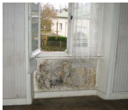
Humidité due à un problème d'infiltration
